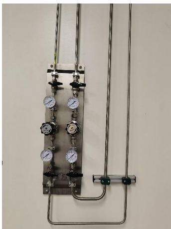
图 8 实验室压缩空气和氮气输送管道
