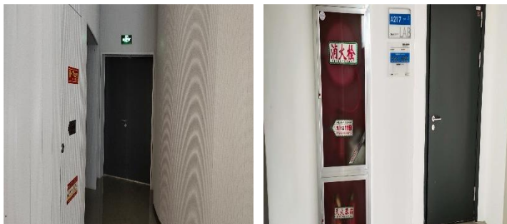
图 2 办公室过道消防器材
