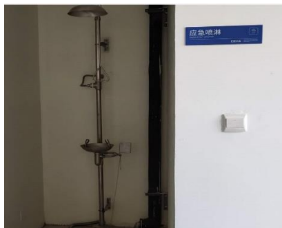
图 5 各楼层过道紧急喷淋设备
